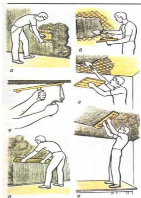
Рисунок 6 – Намазывание штукатурного раствора: а - соколом на стену; б - кельмой на стену; в - соколом на потолок; г - кельмой на потолок; д - полутёрком на стену; е - полутёрком на потолок.
