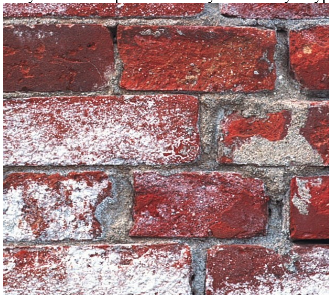
Рисунок 3 – Потрескавшийся участок штукатурки
