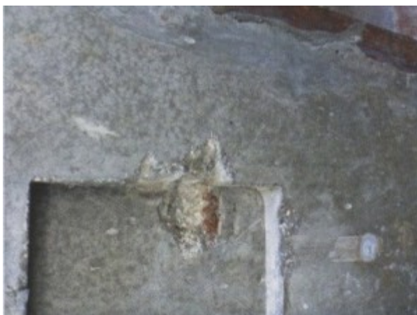
Рисунок 2– Скол бетона с оголением и коррозией рабочей арматуры
