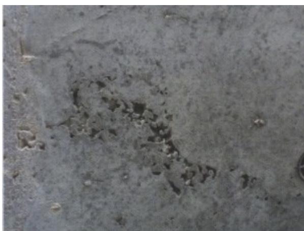
Рисунок 4–Непровибрированные участки с образованием каверн под металлической балкой
