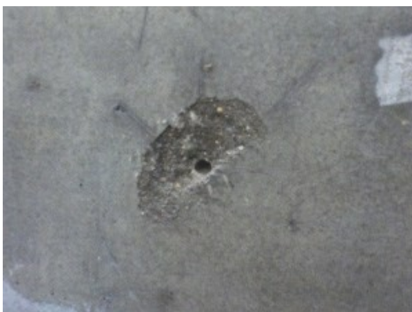
Рисунок 1– Скол бетона с оголением и коррозией рабочей арматуры
