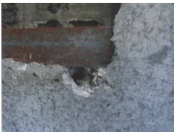
Рисунок 3–Непровибрированные участки с образованием каверн под металлической балкой
